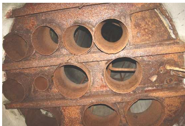
Р и с. 6. Дюзы в нижней части трубы и металлоконструкции
